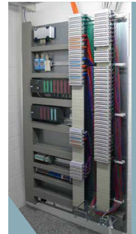
Die neue SiAxma-Zentrale regelt den Zutritt von ca. 2500 Personen.
